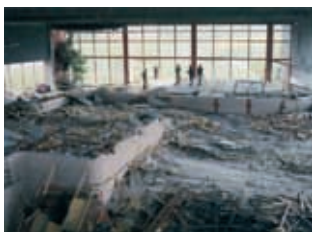
U švicarskom je Ulsteru 1985. godine pao ovješeni betonski strop zatvorenog bazena. Ovjesi stropa od nehrđajućeg čelika s vanjske strane nisu pokazivali nikakve nedostatke, no iznutra su bili djelomično potpuno uništeni korozijom uslijed napuklina zbog naprezanja.
